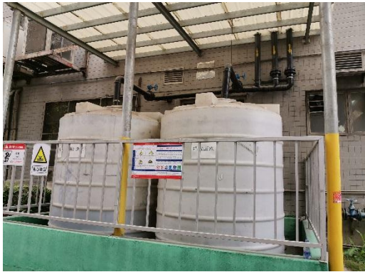
项目废水收集装置 1
