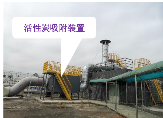
项目活性炭吸附装置
