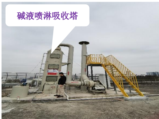
项目碱液喷淋吸收塔
