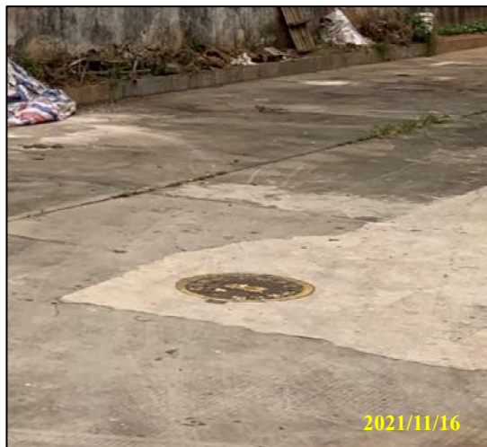
项目园区雨水井盖
