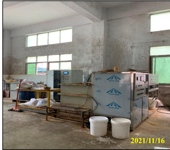
项目废水处理设施
